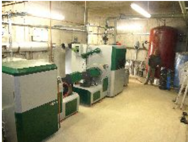
L'intérieur de la chaufferie et les deux chaudières
